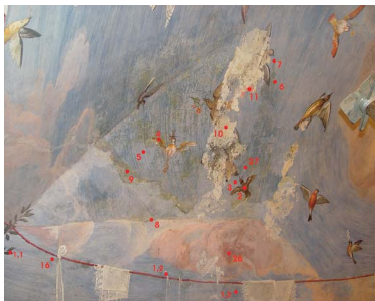
6a, b. Sulla zona interessata dalle infiltrazioni sono stati individuati ventisette punti per le misurazioni di umidità e di contenuto salino del supporto con lo strumento SUSI. I punti di misura 1 e 21 non sono mai stati coperti da impacco, pertanto non sono riportati.
